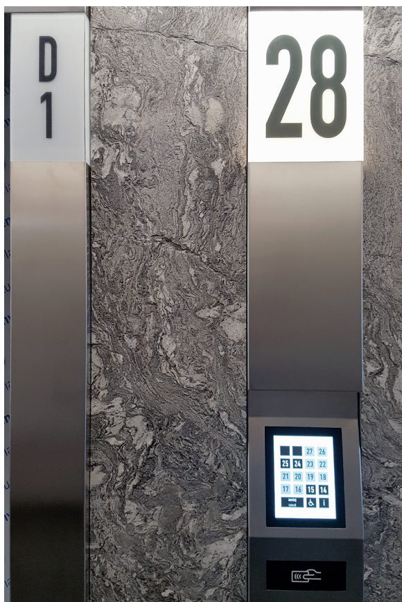
Rys. 2. Panel windy ThyssenKrupp powiązany z systemem INTEGRITI
