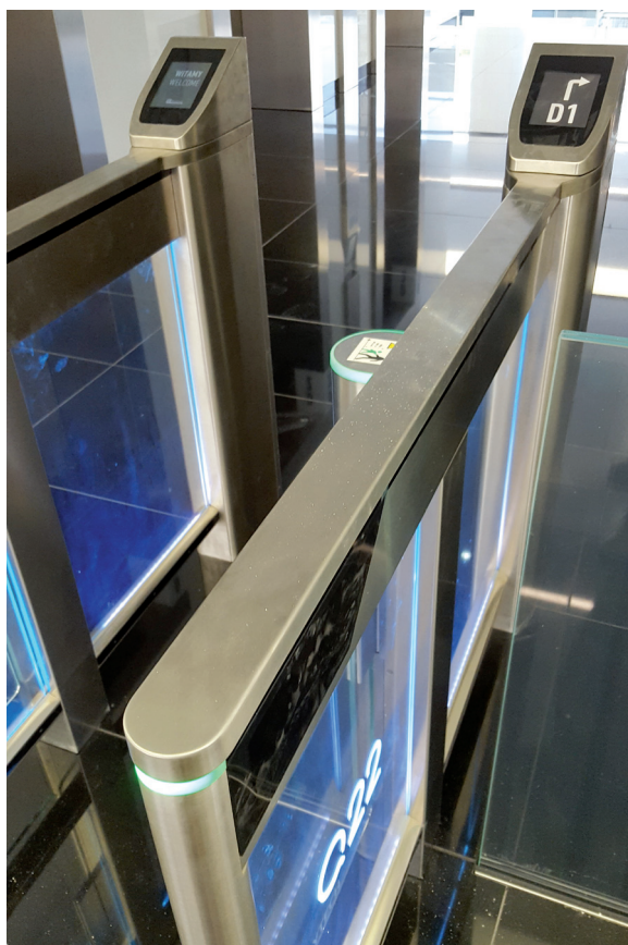
Rys. 1. Szybka bramka wejściowa powiązana z systemami INTEGRITI i ThyssenKrupp
